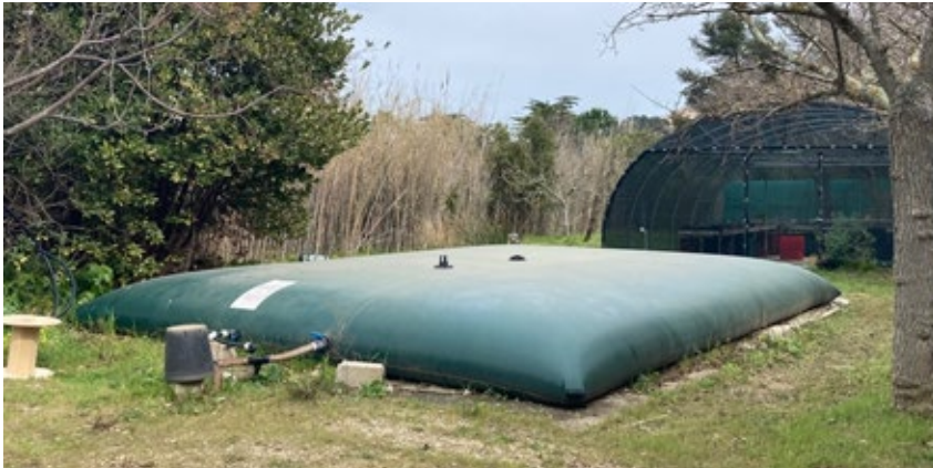
Citerne d'eau externe de pluie de 50m 3 (COPAINS, Porquerolles) ©Babou Verhaegen
