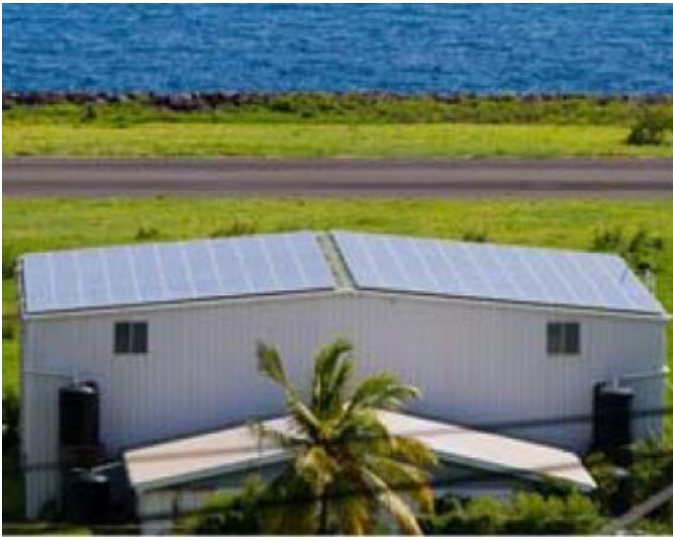
Hangar de l'aéroport de Bequia avec les panneaux photovoltaïques installés sur le toit.
