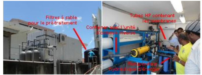
Vue extérieure et intérieure de l'unité de dessalement à Bequia
