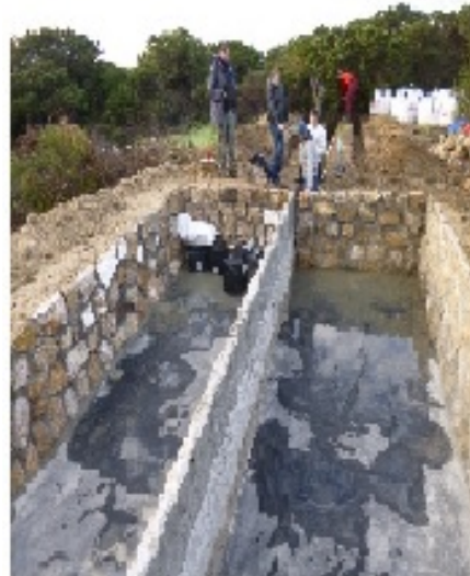
Costruzione del filtro a sabbia (primo piano) e dello spargimento sotterraneo (secondo piano)
