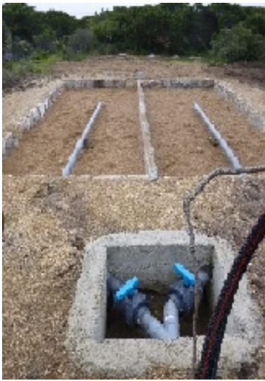
Costruzione del filtro a sabbia (primo piano) e dello spargimento sotterraneo (secondo piano)
